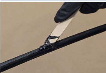
Aplique CJR al defecto
