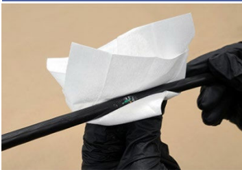
Limpie el área alrededor del defecto
