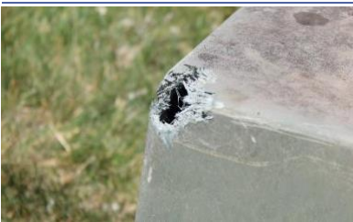
Daño en la caja
